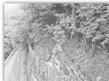
【赤間白浜線崩落現場】
