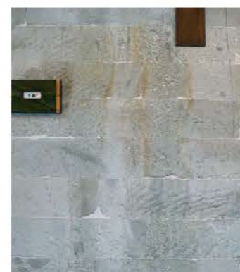
経年劣化による伊豆石壁面の雨漏り跡。
