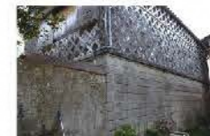
経年劣化により損傷の激しい北側外壁。職人不足や後継者の問題から改修の目途が立たない。
