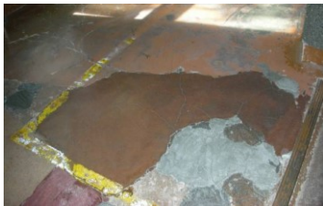
床仕上げの剥がれ
