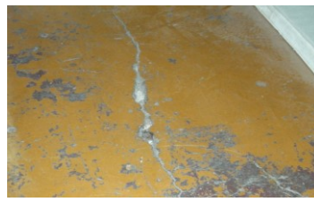
床のひび割れ
