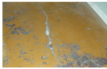
床のひび割れ
