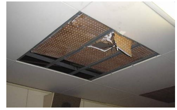
天井材の落下・剥がれ
