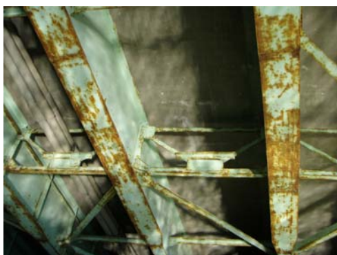
鋼橋の損傷（錆の発生）
