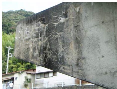
橋脚の損傷（ひび割れの発生）
