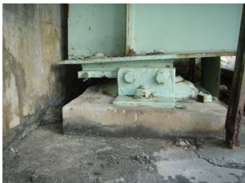
支承の損傷（機能障害）
